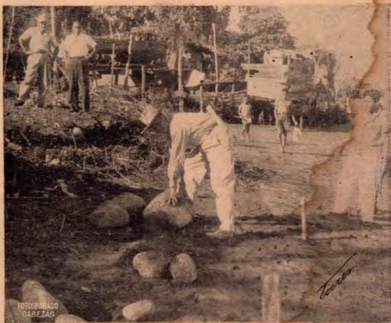
Acto simpático y sencillo fué la colocación de la primera piedra, con lo que inmediatamente se dió comienzo a la construcción de los escolleros en el Barrio del Carmen
